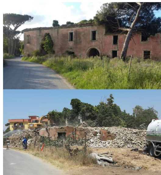
Giugliano (NA) – Casale agricolo storico demolito per fare spazio ad un amorfo condominio (piano casa).
